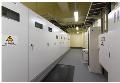
26. 1F 電機室.jpg
